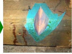
CCA注入部分が青く発色
